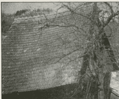
Este jeden pohľad na barabizňu v Ilave. Ktovie, dokedy bude ešte táto chalupa stáť?
